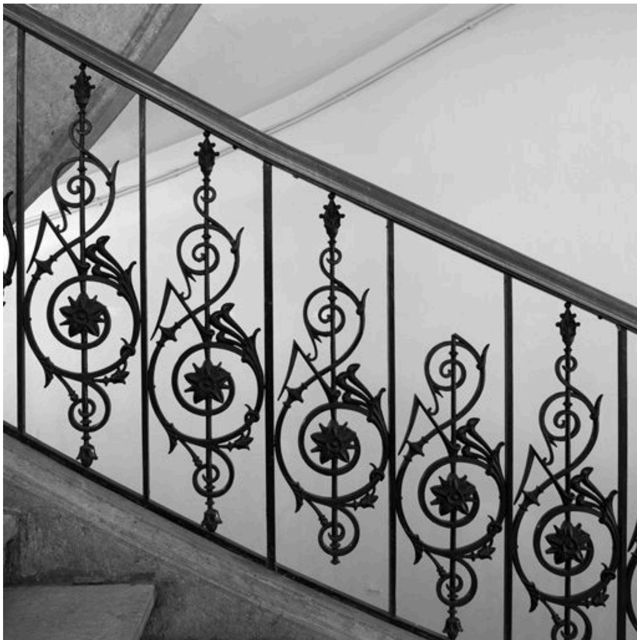
L'escalier : détail de la rampe, en fonte de fer, semblable à celle de la maison située 53 boulevard des Brotteaux, Lyon 6e
