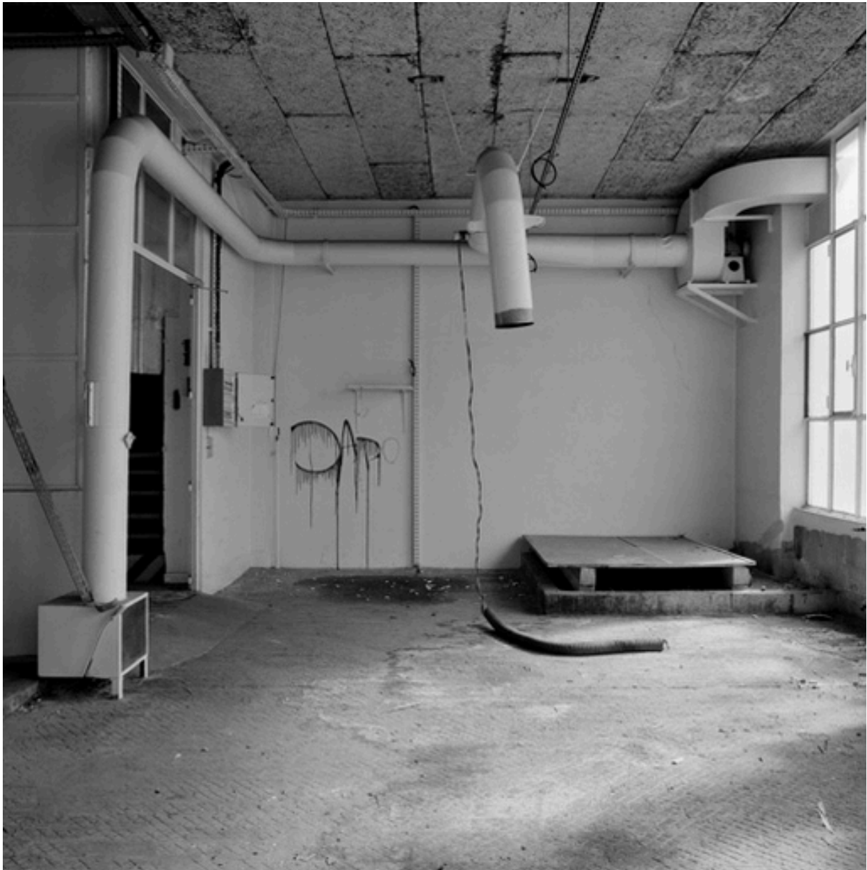
Struture de ventilation
