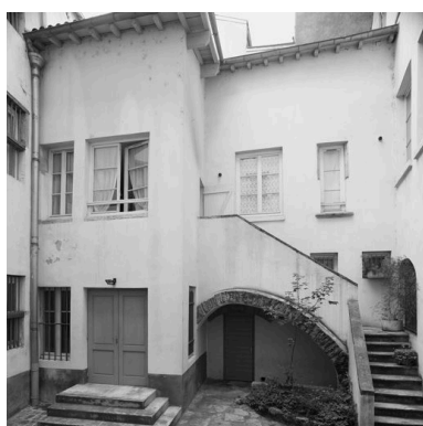
Cour IV, élévation du bâtiment 3 et escalier extérieur Phot. Didier Gourbin IVR82_20056901514NUC
