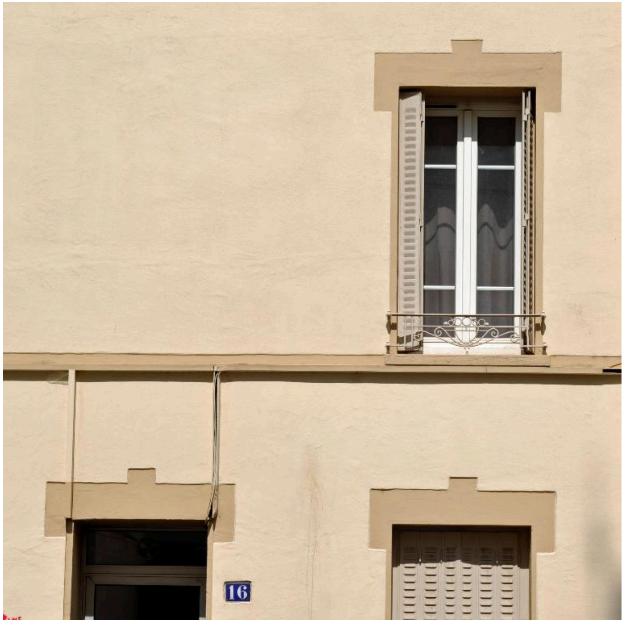
Elévation sur rue, vue rapprochée montrant les effets de décor dans l'enduit
