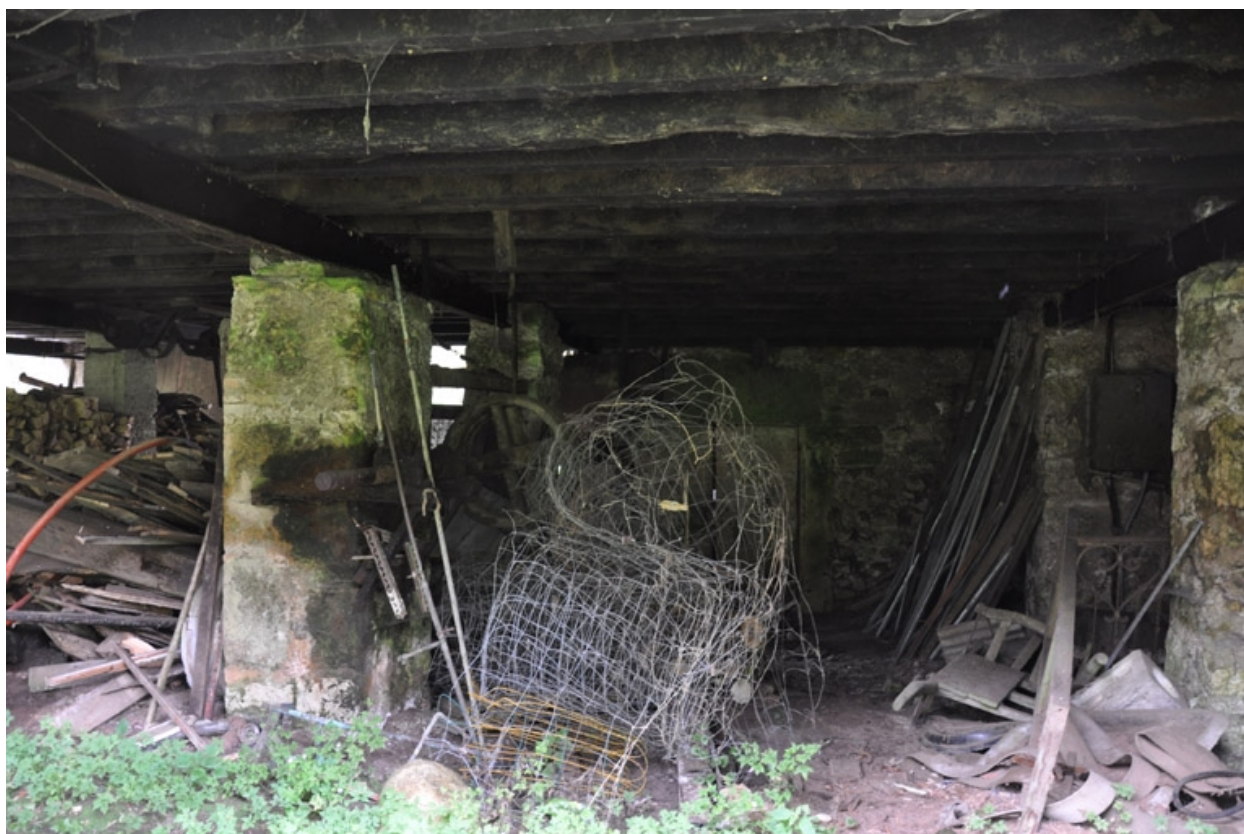
Vue de l'étage de soubassement avec un axe de transmission
