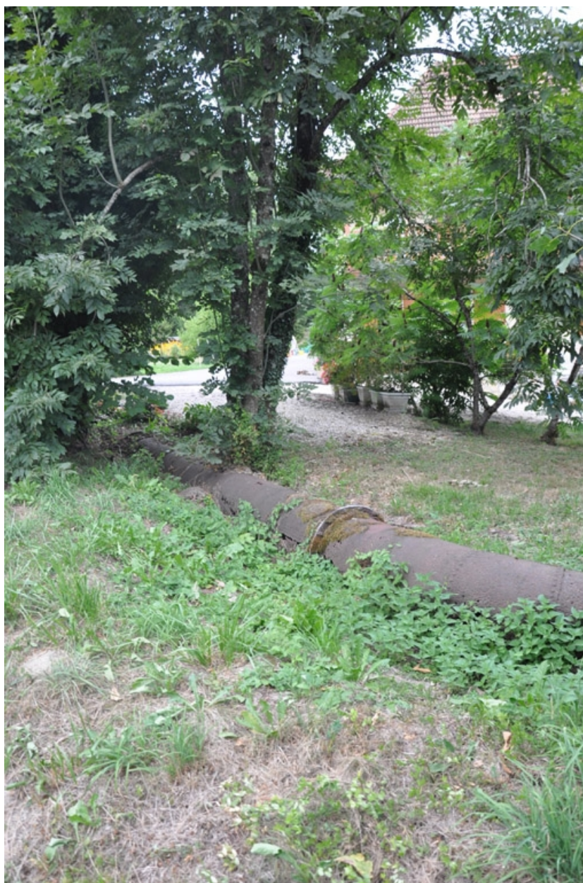
Conduite forcée entre la réserve et la turbine
