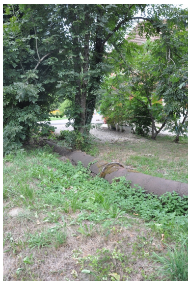
Conduite forcée entre la réserve et la turbine Phot. Yannick Milleret IVR82_20107300439NUCA
