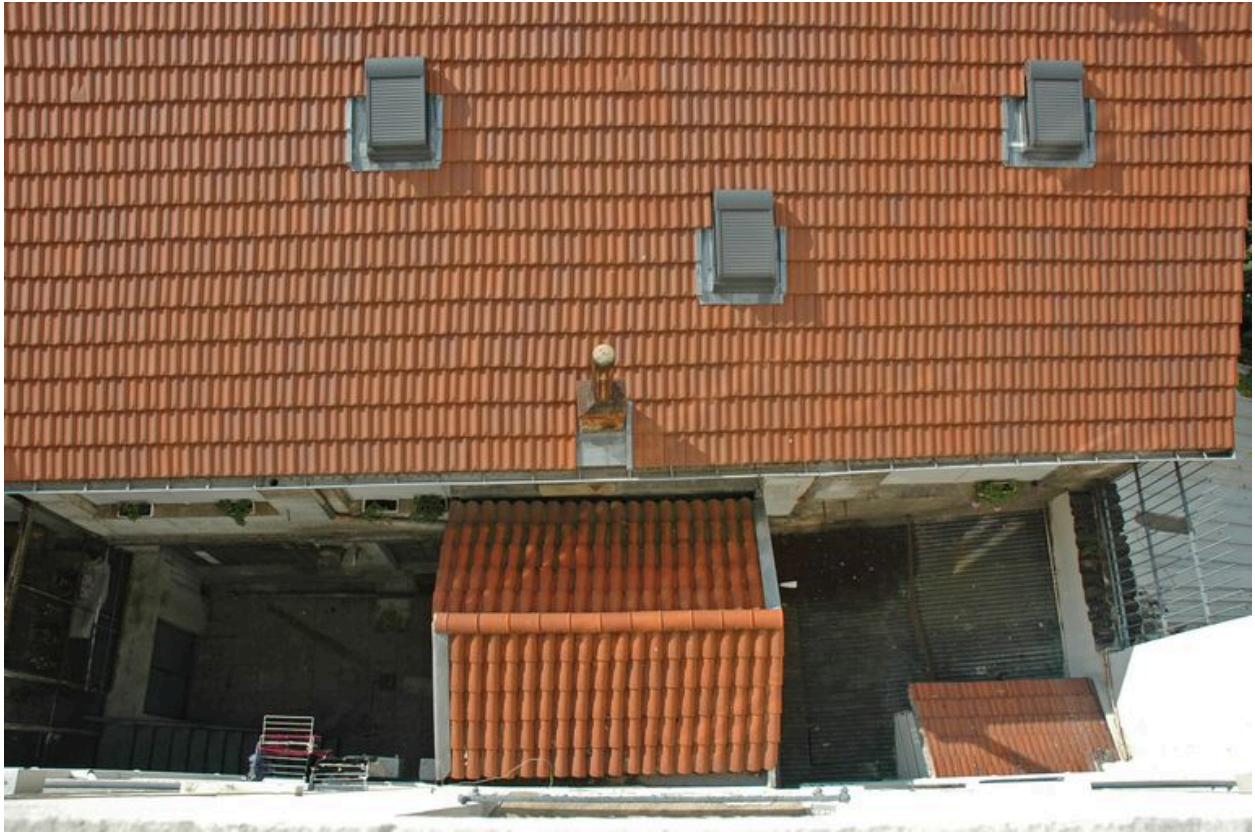
Vue de la cour : loge de concierge perpendiculaire à l'immeuble et ancien atelier construit dans la cour
