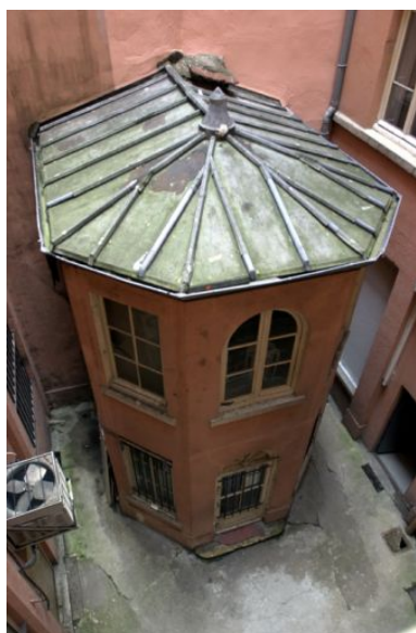
Loge de concierge dans la cour commune, vue générale Phot. Bernard Ducouret IVR82_20056902673NUCA
