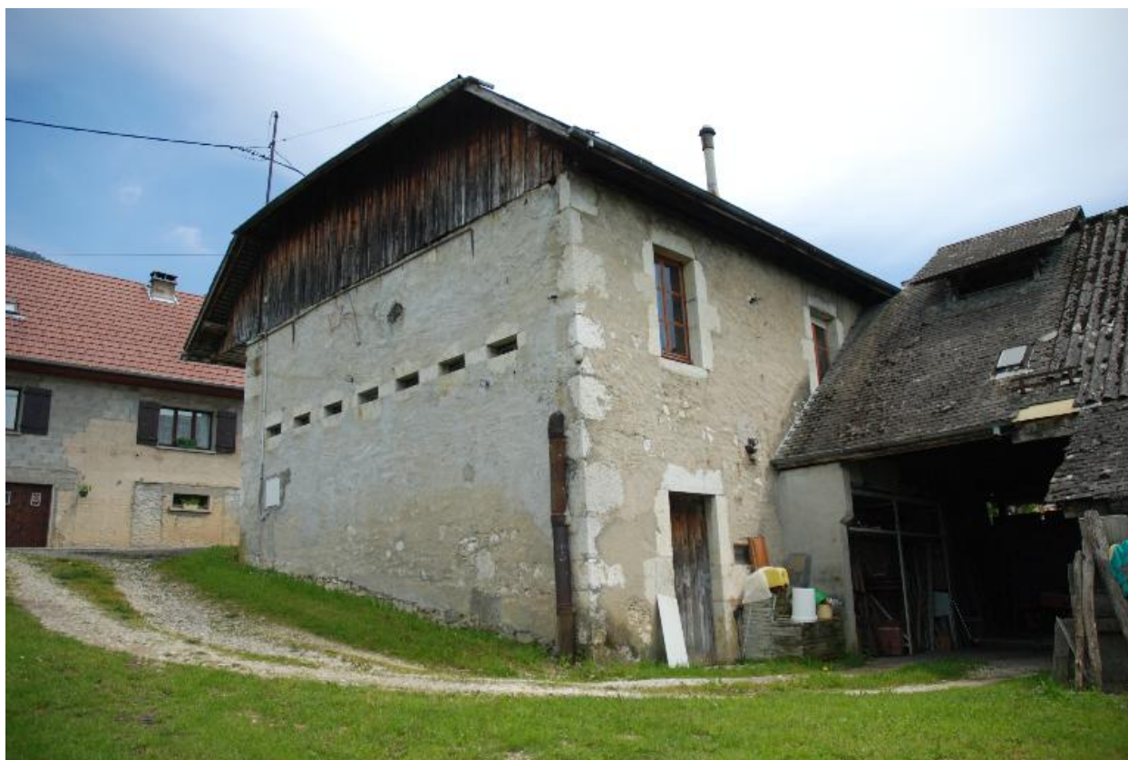
Vue de la fruitière depuis le nord-ouest : accès à la cave, aérations de la salle de refroidissement du lait.
