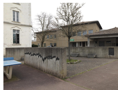
Vue d'ensemble de l'installation. Phot. Franck Trabouillet IVR84_20210100284NUCA
