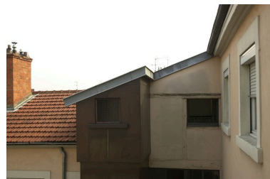
Cage d'escalier est : dernier étage vu depuis la cage d'escalier ouest Phot. Véronique Belle IVR82_20076902967NUCA
