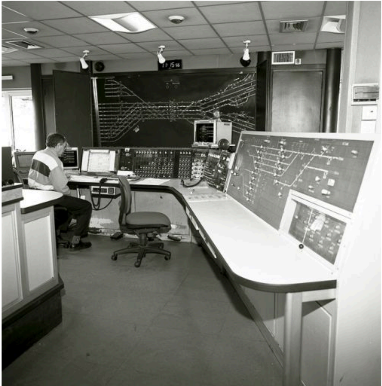
Vue des postes de commande
