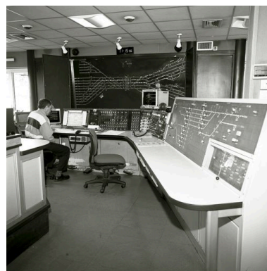
Vue des postes de commande Phot. Eric Dessert IVR82_20026903536X
