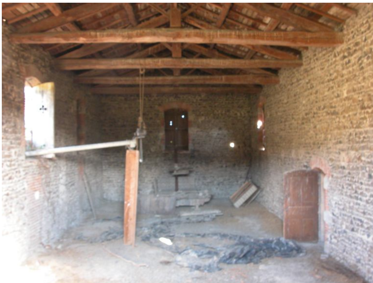
Vue intérieure du cuvage.
