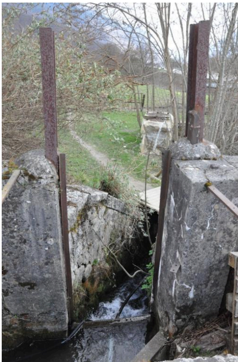
Vue d'une vanne du canal d'amenée.
