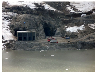
Prise d'Eau installée dans l'un des deux tunnels communiquant avec les deux barrages d'Emosson Phot. Samir Mahfoudi, Autr. Viviano Mancini IVR82_20117401270NUCA
