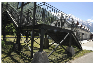
Vue de l'escalier partant de la cour des voyageurs Phot. Samir Mahfoudi IVR84_20257401556NUCA
