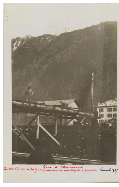
Gare de Chamonix, Installation de l'échafaudage devant servir au montage. 1907 (AD Haute-Savoie : 36 Fi 532) IVR84_20257401646NUCA
