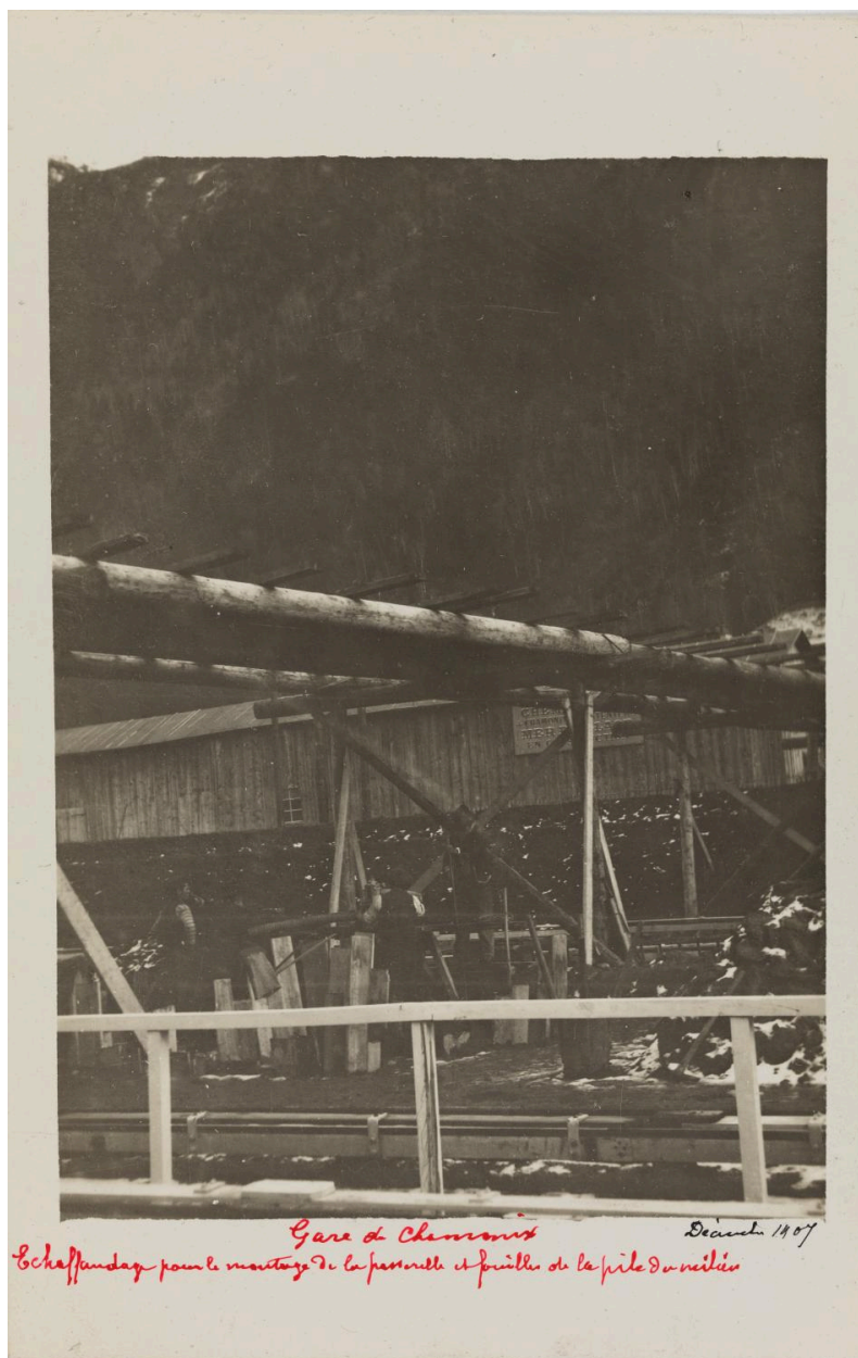
Gare de Chamonix, échafaudage pour le montage de la passerelle. 1907 (AD Haute-Savoie : 36 Fi 530)
