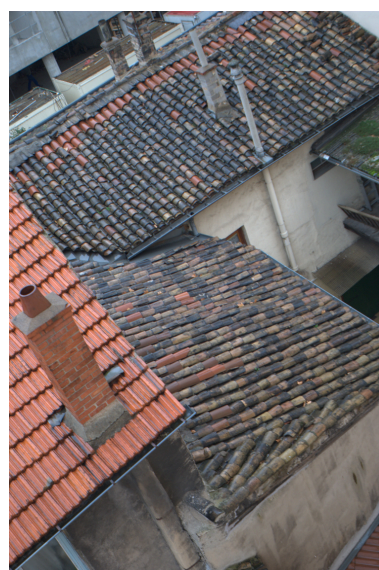
Elévation postérieure, cour et corps de bâtiment en retour Phot. Maryannick Chalabi IVR82_20126902431NUCA
