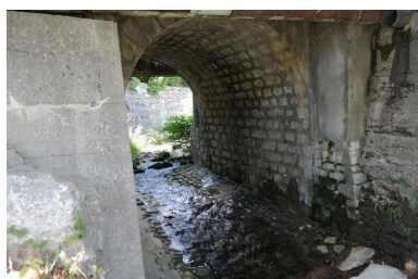
Pont du Nant de la Ville, détail de la voûte et du lit du ruisseau Phot. Pascale Renard IVR84_20207401212NUCA
