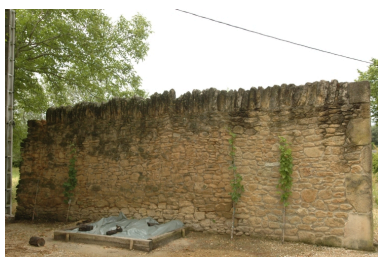
Les Fournaches, exemple de mise en oeuvre d'un mur de clôture. Phot. S. Joly IVR82_20092600502NUCA
