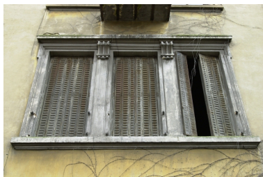
Détail d'une baie de la façade du bâtiment en fond de cour Phot. François Blanchetière IVR82_20016901572NUCA
