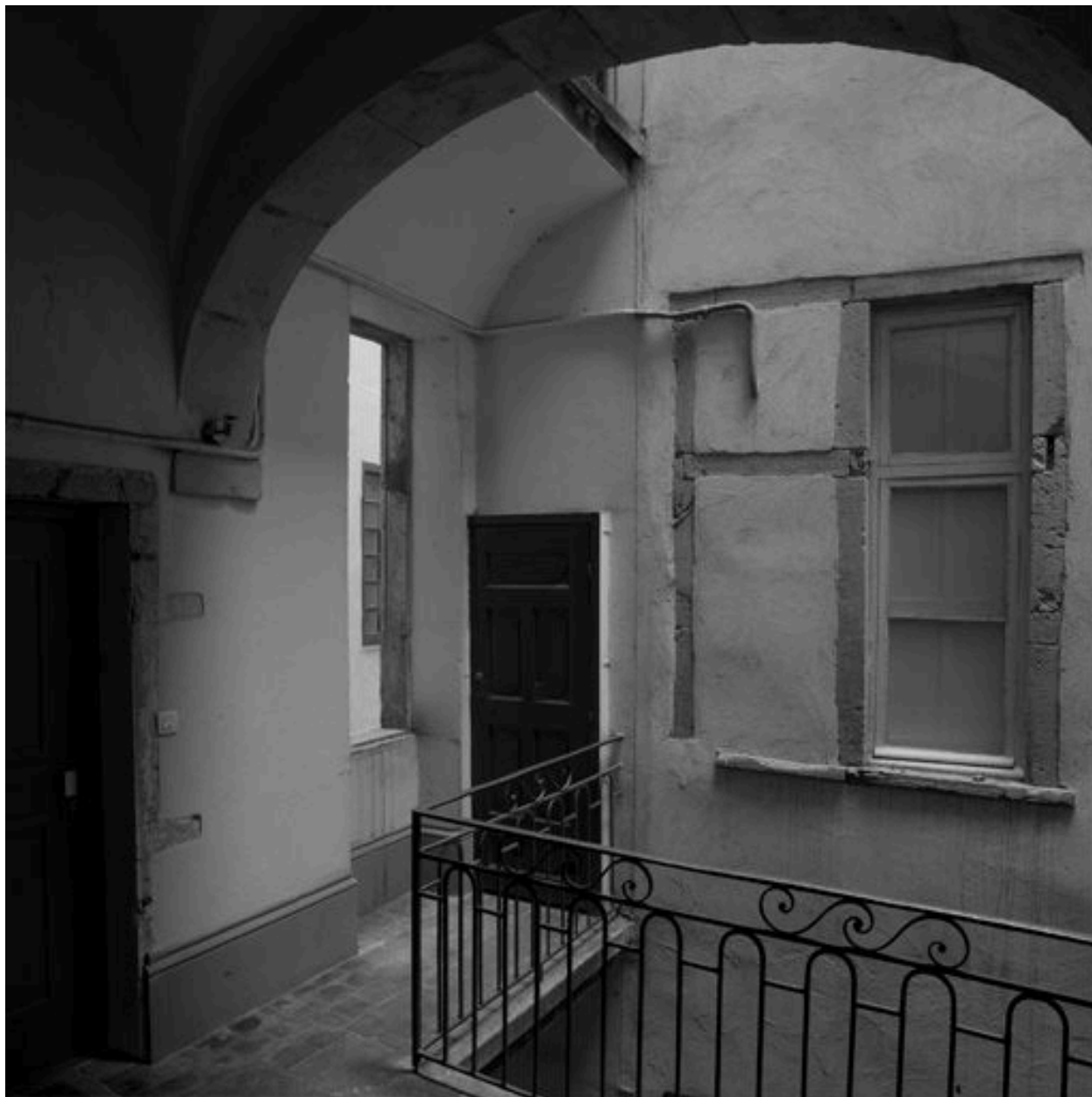
2e cour, coursière conduisant aux anciens lieux d'aisance, vue à hauteur du 2e étage
