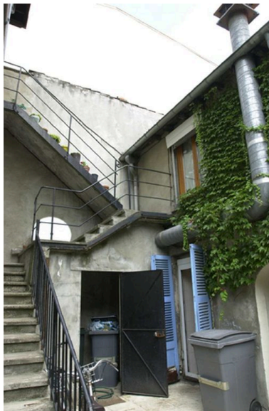
Vue de l'escalier desservant les étages de AD 7 B et AD 7 C Phot. Coralie Belleville IVR82_20046904619NUCA
