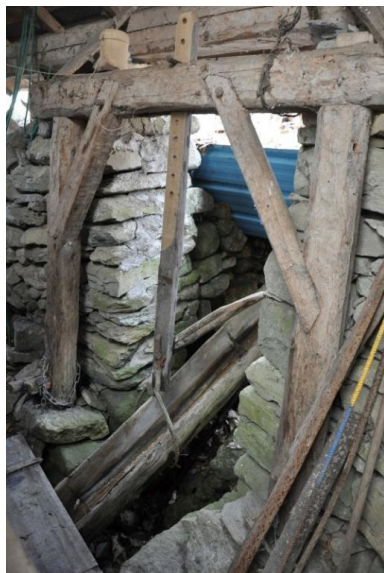
Arrivée de la dérivation alimentant la roue située sous le bâtiment. Phot. Clara Bérelle IVR84_20197300104NUCA
