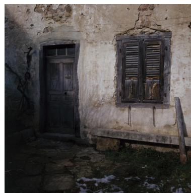
Détail de la porte et de la fenêtre du rez-de-chaussée. Phot. Eric Dessert IVR82_20014200587XA
