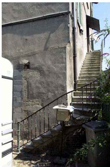
Détail de l'escalier extérieur situé sur les façades latérale et arrière donnant accès aux appartements Phot. François Blanchetière IVR82_20016902256NUCA
