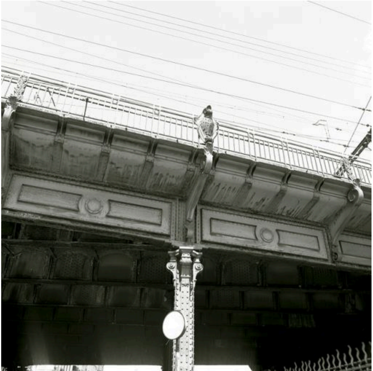
Travée de rive sur le quai Perrache : détail d'une pile et de l'accroche au tablier
