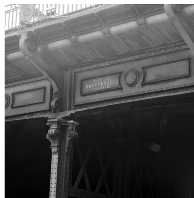
Travée de rive, quai Perrache : détail d'un pilier Phot. Jean-Marie Refflé IVR82_20016902864X
