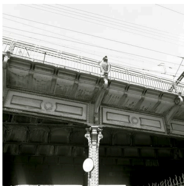
Travée de rive sur le quai Perrache : détail d'une pile et de l'accroche au tablier Phot. Eric Dessert IVR82_20026903818X
