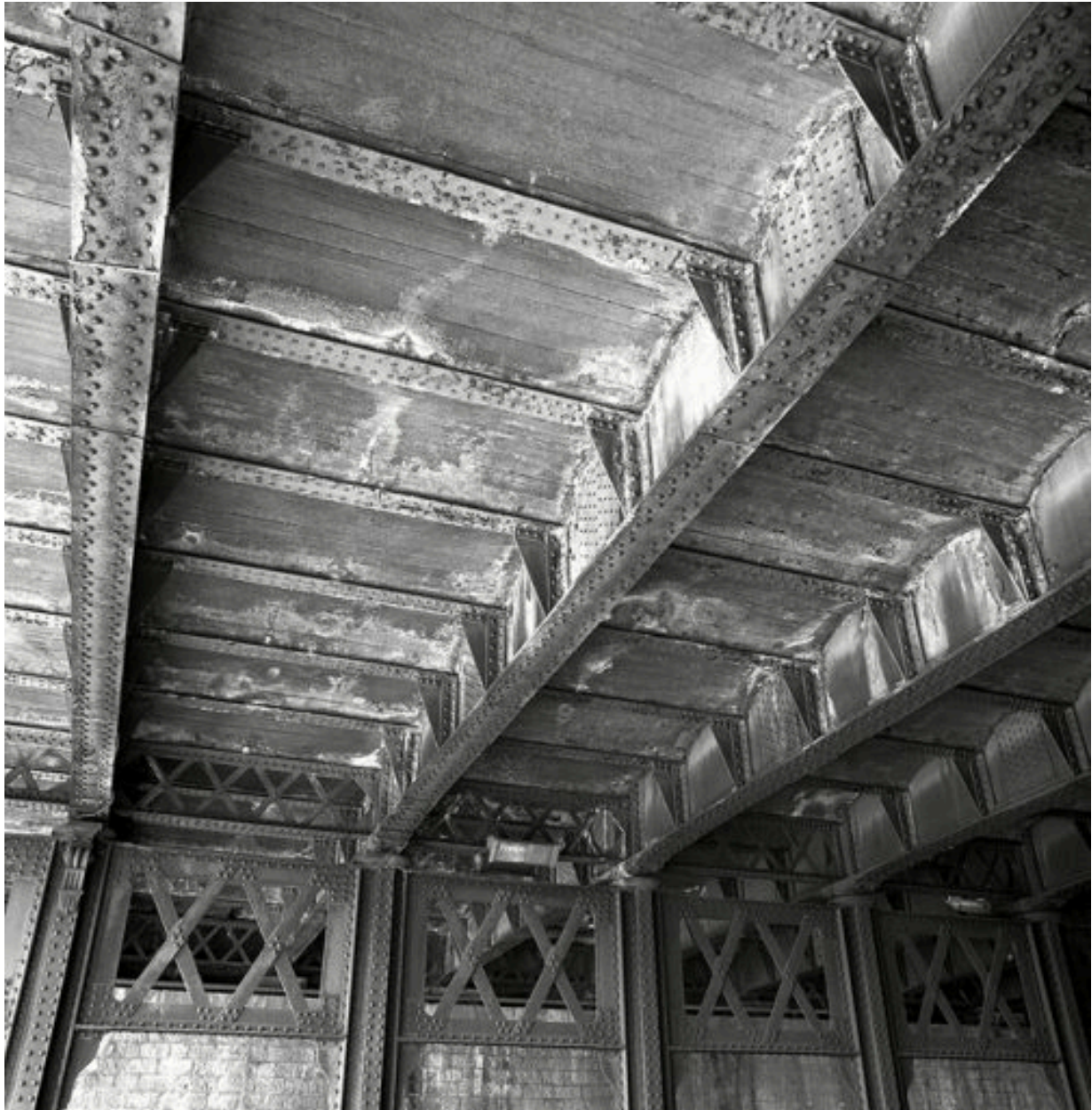
Travée de rive sur le quai Perrache : vue d'ensemble du dessous du tablier
