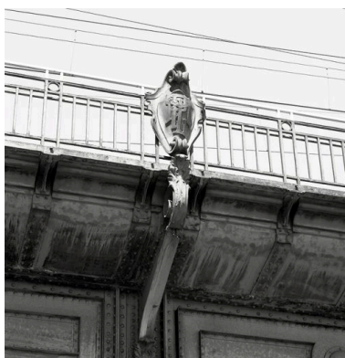
Travée de rive, quai Perrache : détail du cartouche du garde-corps, marqué PLM Phot. Eric Dessert IVR82_20026903814X
