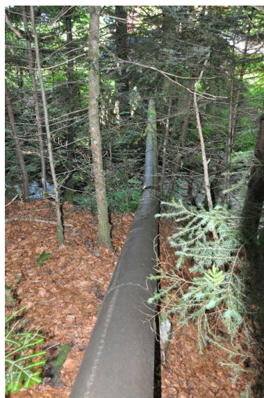
Vue de la conduite forcée. Phot. Clara Bérelle IVR82_20137301865NUCA
