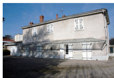
Vue de l'élévation antérieure, côté jardin, depuis le sud est Phot. Catherine Guégan IVR82_20076900006NUCA
