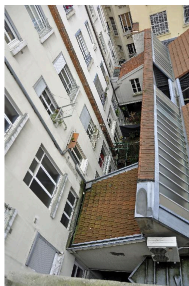
Cour des 5-7, rue de Bonald : loges de concierges en encorbellement Phot. Magali Delavenne IVR82_20146902995NUCA
