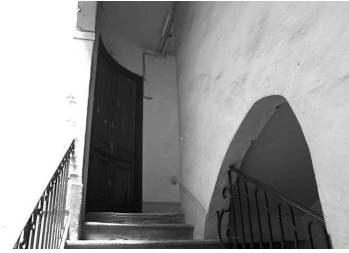
Escalier, vue prise vers un palier. La porte marque l'entrée de la galerie entre les 2 cours Phot. Lore Derail IVR82_20046900090NUCA
