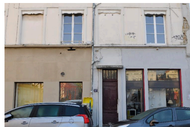
Rez-de-chaussée dénaturé, moellons apparents dans une lacune de l'enduit Phot. Magali Delavenne IVR84_20166902224NUCA
