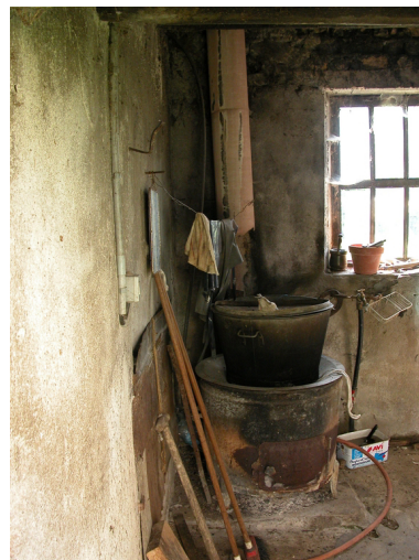
Vue intérieure de la chaudière. Phot. Caroline Guibaud IVR82_20124201084NUCA
