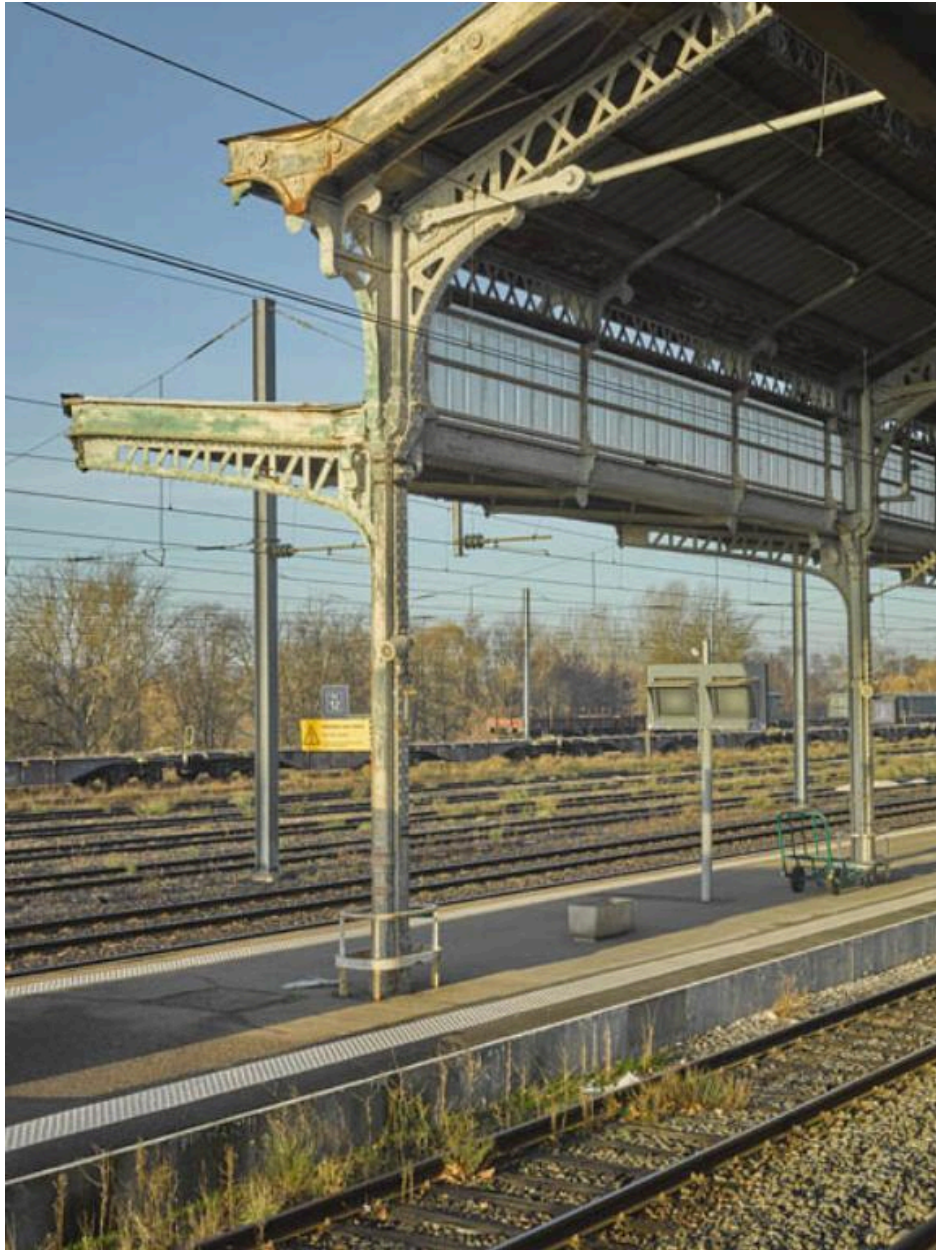
Détail de la structure métallique de la grande halle protégeant les quais de la gare de Saint-Germain-des-Fossés.
