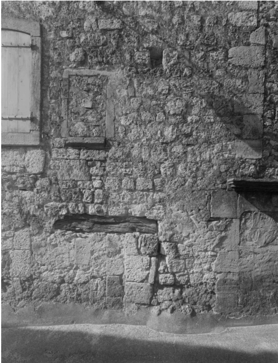
Détail de la façade, partie gauche, montrant plusieurs remaniements : reprise de construction et baies murées.
