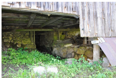
Vue du canal de fuite sous le bâtiment. Phot. Clara Bérelle IVR82_20137301776NUCA
