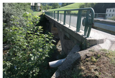
Pont de Vers l'Usine, vue de la face amont Phot. Pascale Renard IVR84_20207401047NUCA
