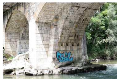
Pont de Tasset, détail de la pile centrale Phot. Pascale Renard IVR84_20207403871NUCA
