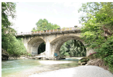
Pont de Tasset, vue de la face aval Phot. Pascale Renard IVR84_20207403867NUCA
