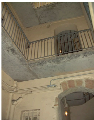
Vue partielle de la coursière reliant l'escalier aux appartements situés dans la partie nord-est de l'immeuble Phot. Maryannick Chalabi IVR82_20006900375NUCA
