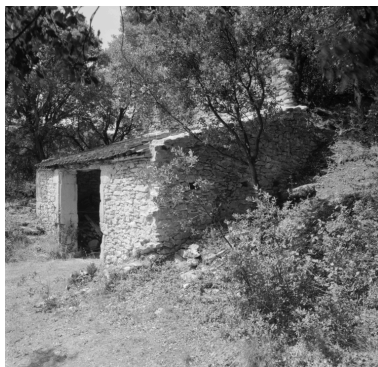
Vue latérale droite du four à chaux montrant le glacis Phot. Alain Franchella IVR82_19992600324X
