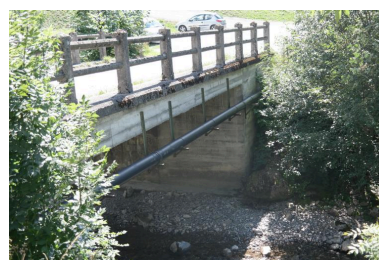
Pont de Chez les Ogays, vue de la face aval Phot. Pascale Renard IVR84_20207400947NUCA
