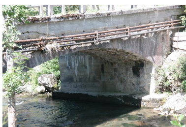
Pont de Chez les Ogays, vue de la voûte Phot. Pascale Renard IVR84_20207400949NUCA
