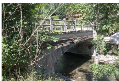
Vue générale du pont de Chez les Ogays Phot. Pascale Renard IVR84_20197401204NUCA
