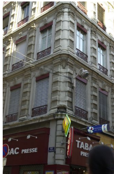
Angle des deux façades, détail des trois premiers niveaux Phot. Bernard Ducouret IVR82_20046900910NUCA
