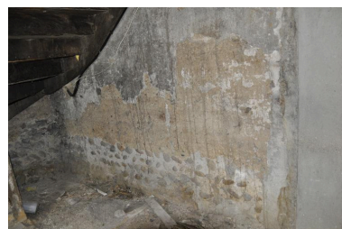
Vue sous l'escalier de la structure en pisé Phot. Nadine Halitim-Dubois IVR82_20146900326NUCA
