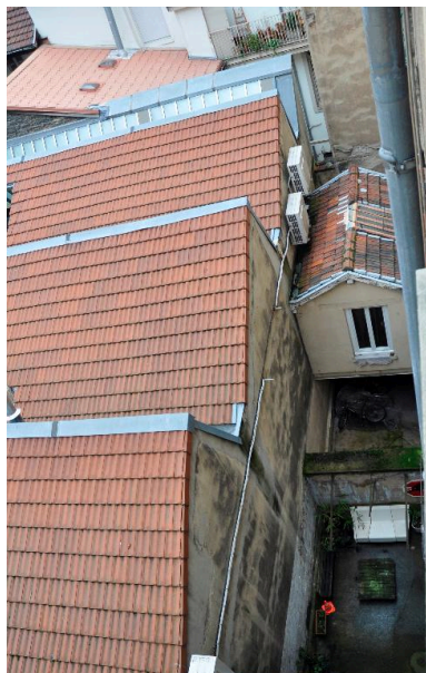
Vue de la cour et de la loge en encorbellement Phot. Magali Delavenne IVR82_20146902920NUCA
