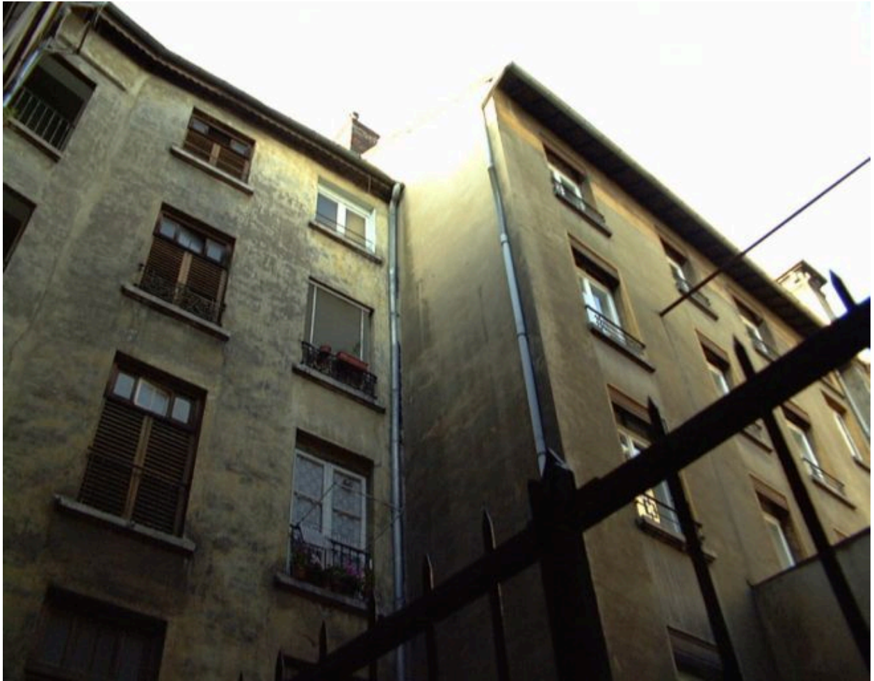
Elévation postérieure du corps de bâtiment rue du Bélier : le décrochement et le partage des immeubles
