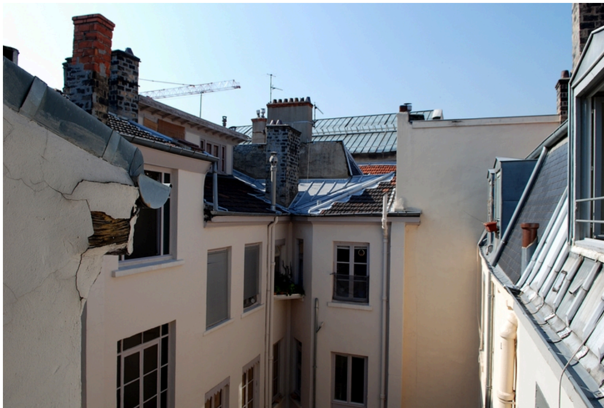
Vue de situation de la verrière depuis l'escalier de l'immeuble sis 15 rue Gasparin
