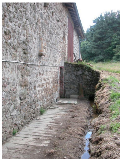
Vue arrière de la ferme, avec montoir et drain. Phot. Thierry Monnet IVR82_20134200185NUCA
