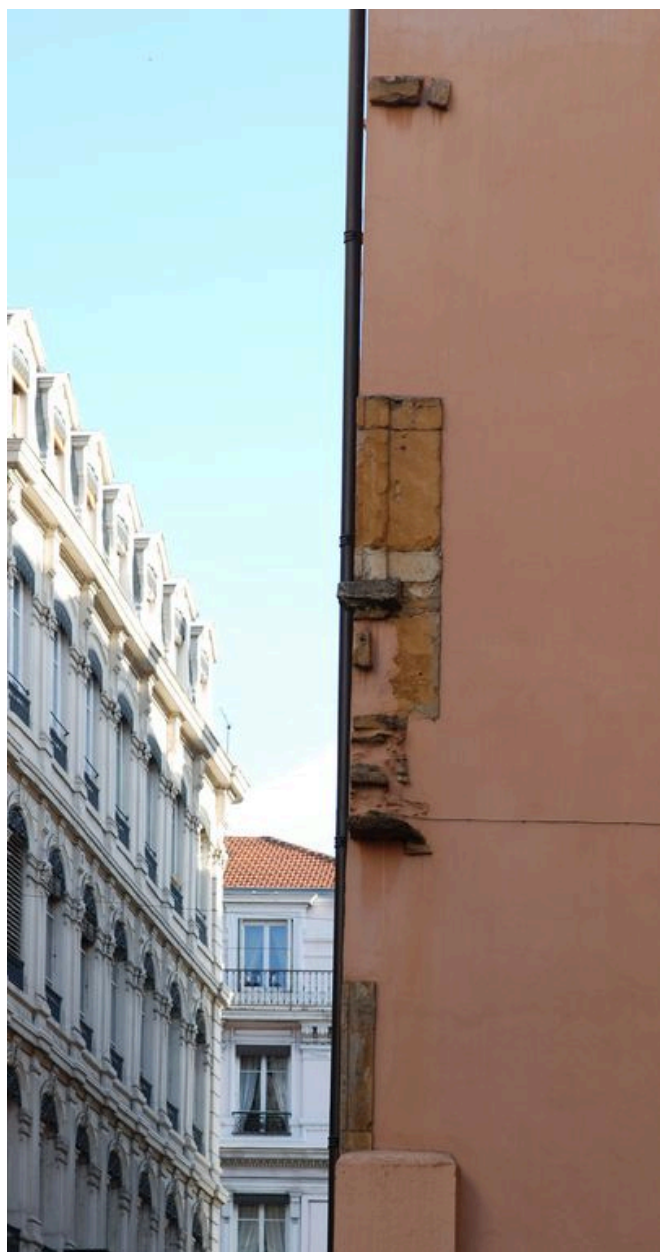
Elévation latérale, détail de l'arrachement
