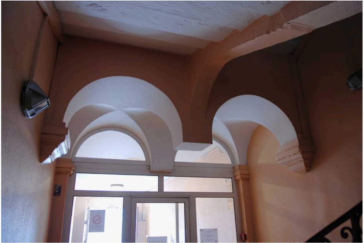
Cage d'escalier, rez-de-chaussée, double croisée d'arrêtes reposant sur culots moulurés et clés pendantes.
