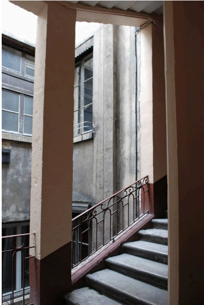
Cage d'escalier, repos entre le deuxième et le troisième étage avec baies sur cour.
