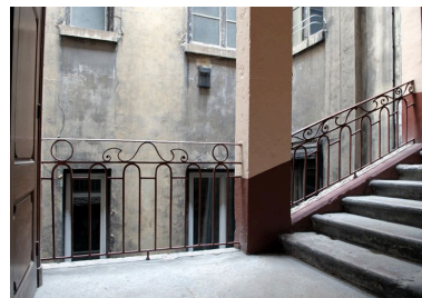
Cage d'escalier, repos entre le deuxième et troisième étage avec baies sur cour. Phot. Catherine Guégan IVR82_20096900592NUCA
