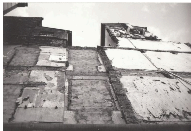
Elévation postérieure avec immeuble adjacent lors des travaux du Bâtiment ISARA (2nd phase), photographie ancienne, 1972 Repro. Julien Defillon IVR82_20096903445NUC
