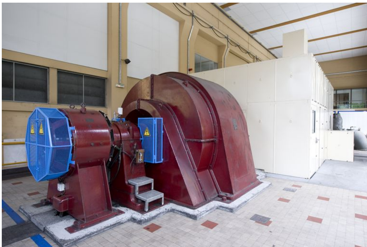
Groupe 2 composé d'une turbine type Francis et d'un alternateur de 12 000 Kw
