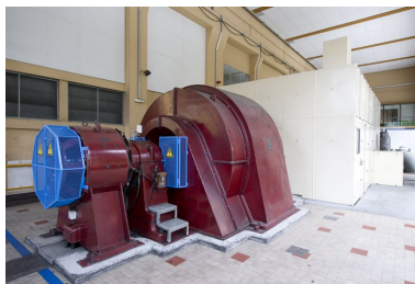
Groupe 2 composé d'une turbine type Francis et d'un alternateur de 12 000 Kw Phot. Samir Mahfoudi, Autr. Samir Mahfoudi IVR82_20117401211NUCA
