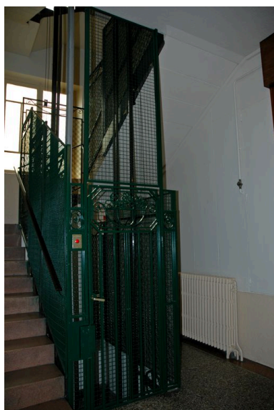
La cage d'ascenseur Phot. Maryannick Chalabi IVR82_20066903097NUCA
