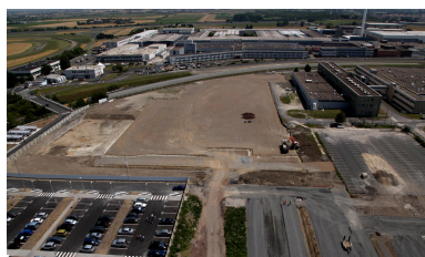
Débuts du chantier de construction du campus RDI, en juillet 2012. Phot. auteur inconnu IVR84_20256301058NUCA
