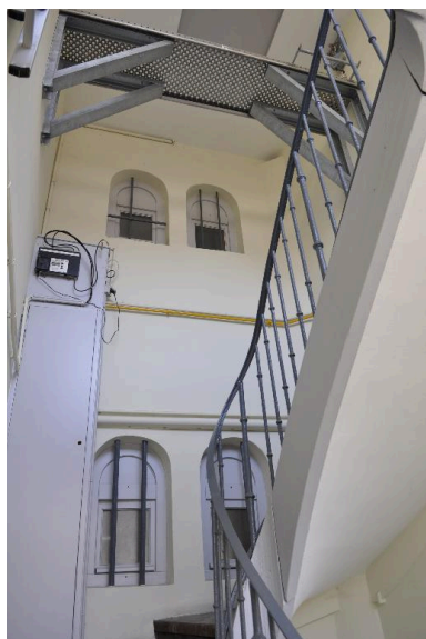
Immeuble sur cour, partie supérieure de la cage d'escalier Phot. Catherine Guégan IVR82_20156902513NUCA
